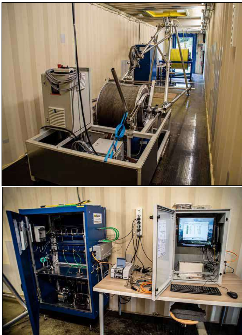
Figure 24 : Dispositif de mesures installé sur le puits FOLS-1A (source : Regalor)
